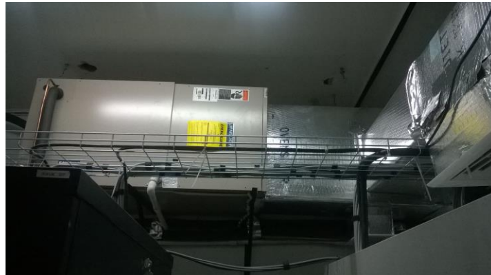
Foto 4: Aire acondicionado costado norte
