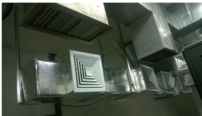
Foto 7: Sistema de distribución de aires costado Norte
