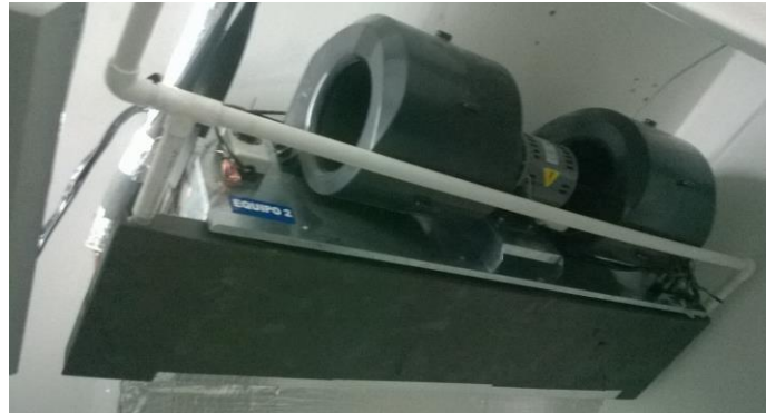
Foto 5: Aire acondicionado costado sur
