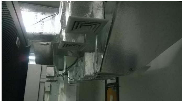
Foto 6: Sistema de distribución de aires costado Sur
