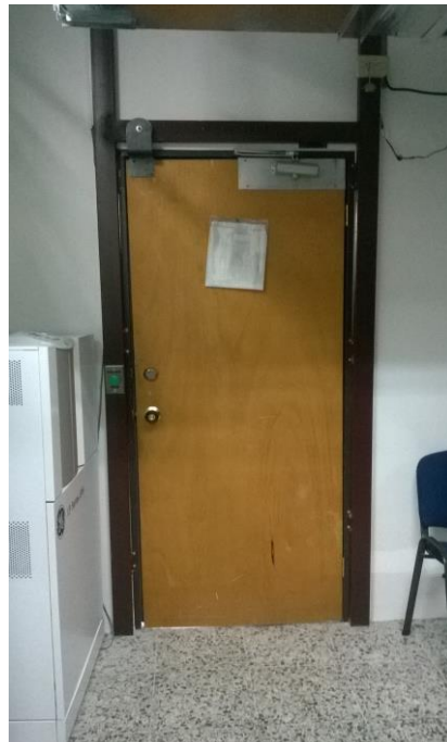
Foto 2: Entrada al Centro de Datos parte interior
