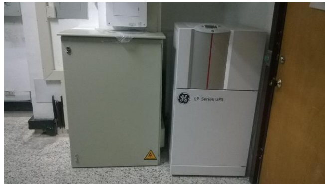
Foto 8: UPS de 40KVA
