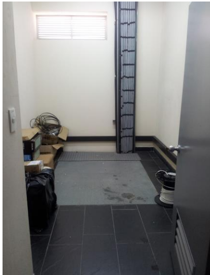
Foto 12: Vista del Espacio del Cuarto Técnico
