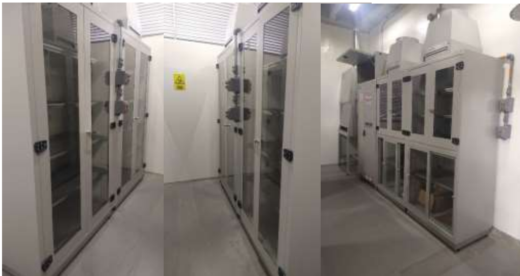
Figura 20. Bodega de sustancias químicas Edificio José María Cabal. Sede Campus Nueva Granada
