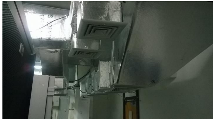
Foto 6: Sistema de distribución de aires costado Sur
