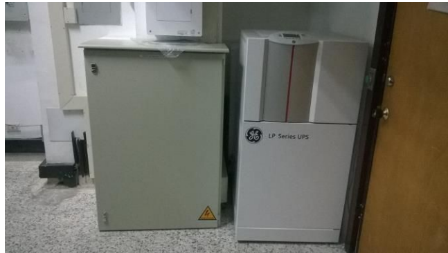
Foto 8: UPS de 40KVA
