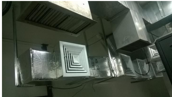
Foto 7: Sistema de distribución de aires costado Norte
