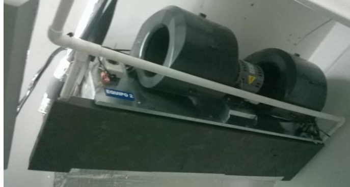
Foto 5: Aire acondicionado costado sur
