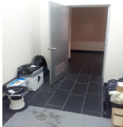
Foto 13: Entrada Cuarto Técnico Vista Interior
