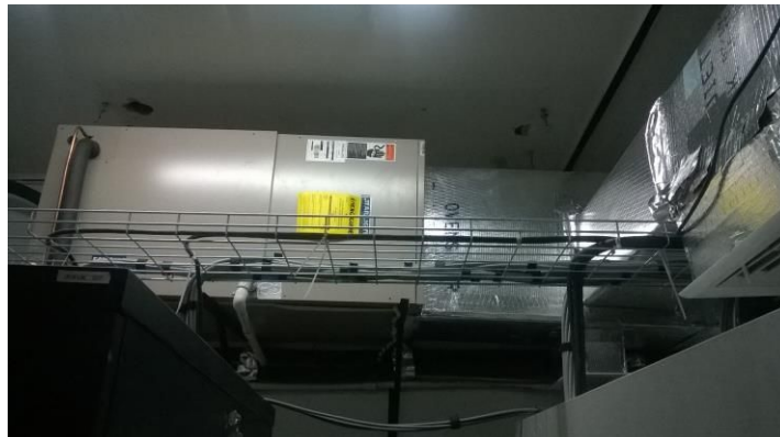
Foto 4: Aire acondicionado costado norte
